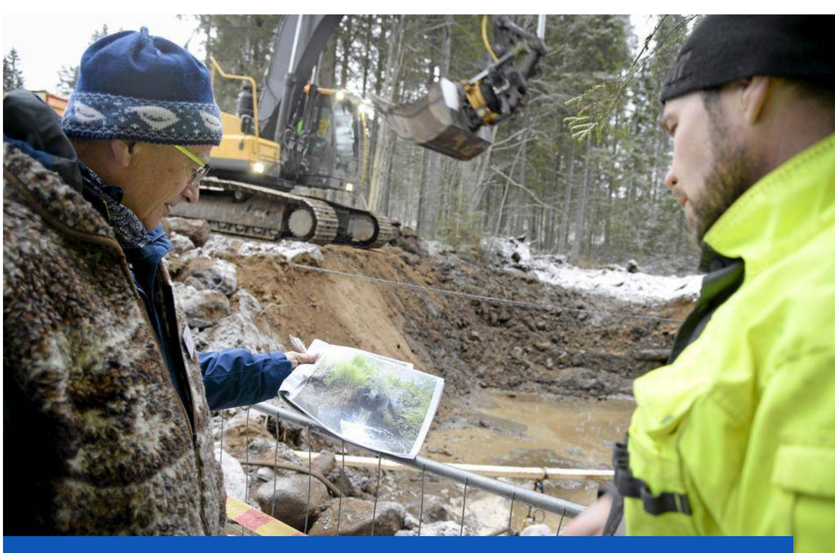
Keski-Suomen ely-keskuksen Anssi Eloranta (vas.) ja Pasi Perämäki kaivoivat työmaalla esiin kuvan jorjattavasta kohdasta ennen toimiin tarttumista. PÄIVI LIIMATAINEN
